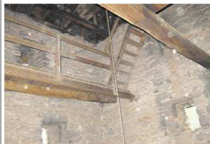
Die alten Holztreppen und -geländer werden abgerissen und durch eine zweiläufige Treppe ersetzt.
